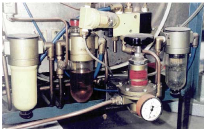
Rys. 6 Przykład słabej jakości rurociągu zamontowanego w instalacji
